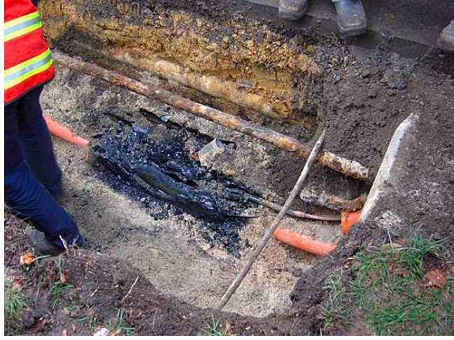
Görsel 5.2. Bir yer altı kablo arızası
