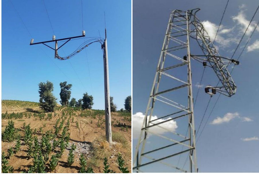
Görsel 5.5. Şiddetli rüzgâr nedeniyle hasar gören elektrik şebekesi
