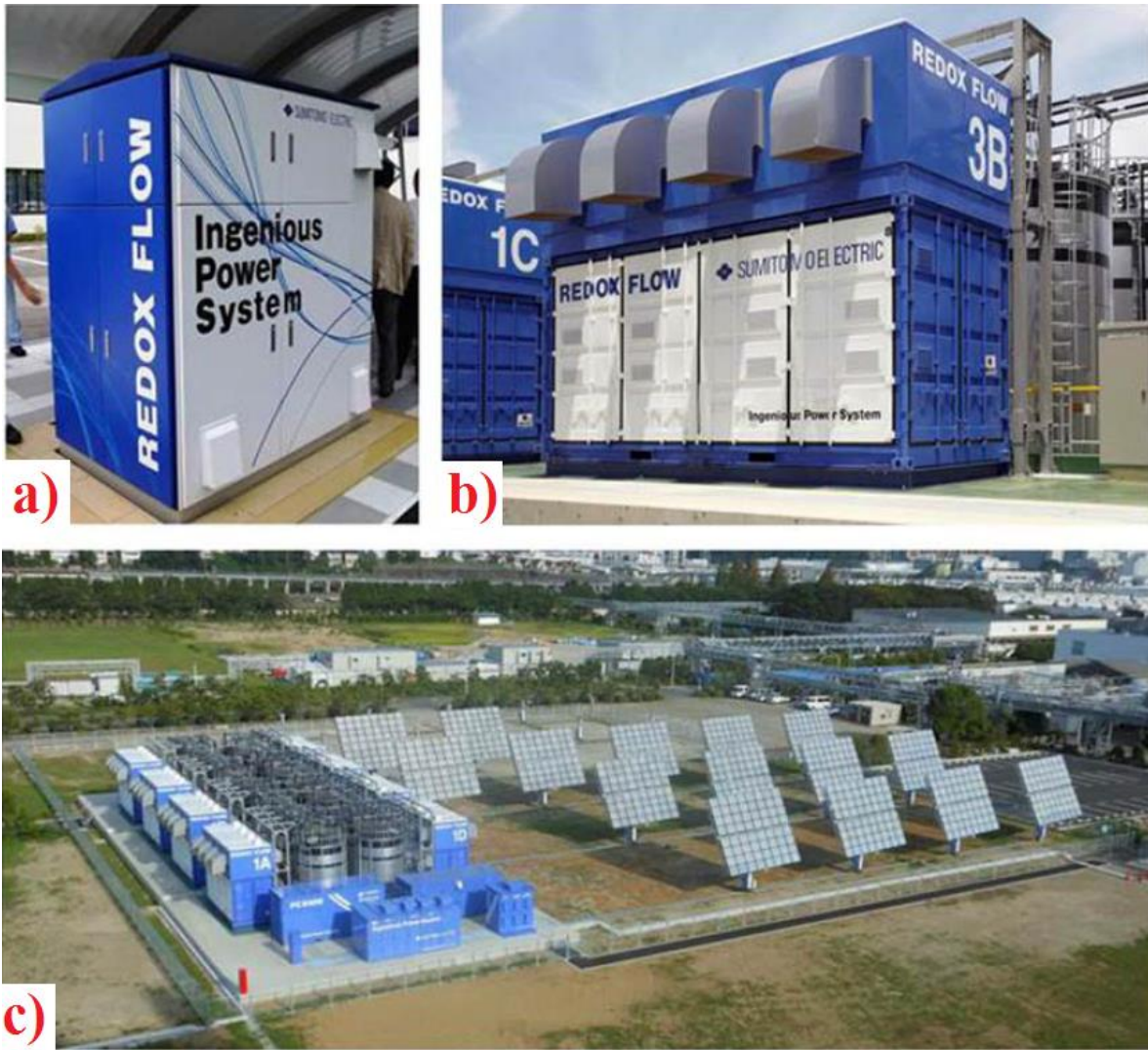
Şekil 1.5. a) SEI vanadyum sistemleri kabinleri b) SEI 125 kW'lık kübik sistemler c) Yokohama'da kurulan 1 MW/5 MWh VRB sistemi (Shibata ve ark., 2013; Skyllas-Kazacos ve McCann, 2015)
