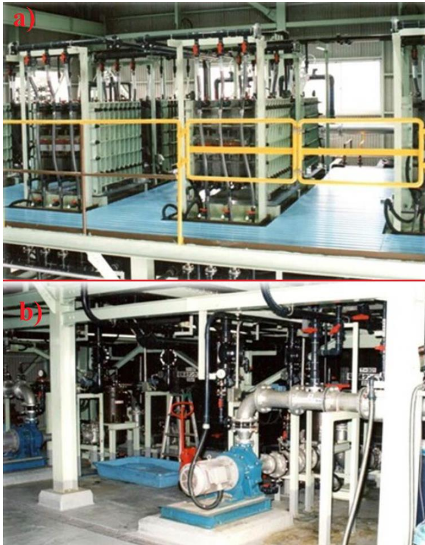
Şekil 1.4. Kashima-Kita Electric Power Corporation tarafından geliştirilen 800 kWh'lik ilk orta boyutlu VRB enerji istasyonu a) VRB hücreleri ve b) elektrolit akışını sağlayan pompa ve boru sistemleri (Skyllas-Kazacos ve McCann, 2015)
