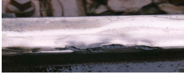
Şekil 3.13. Ray üzerinde oluşan kabuklanma [27]
