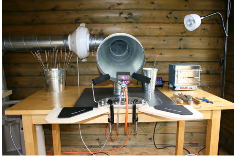
Görsel 3.12. Havalandırma Sistemi.
