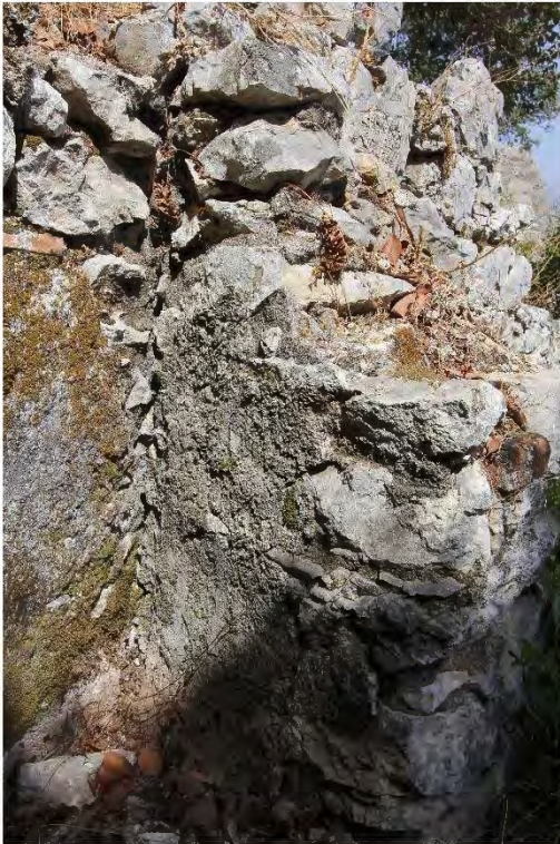
b) Yamaç Yerleşimi Yukarı Kilise batı duvar ve payanda arasındaki dilatasyon derzi.
