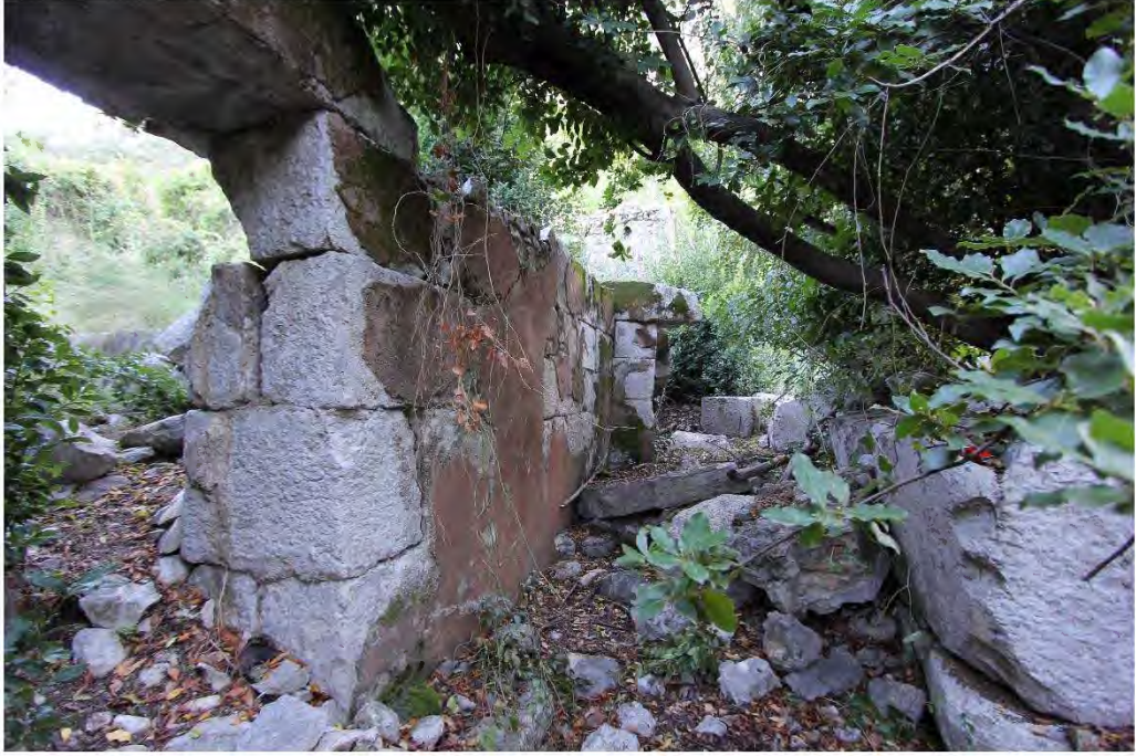
a) Olympos Güney Kent, Liman Hamamı batı duvar, dış cephe, güneye bakış.
