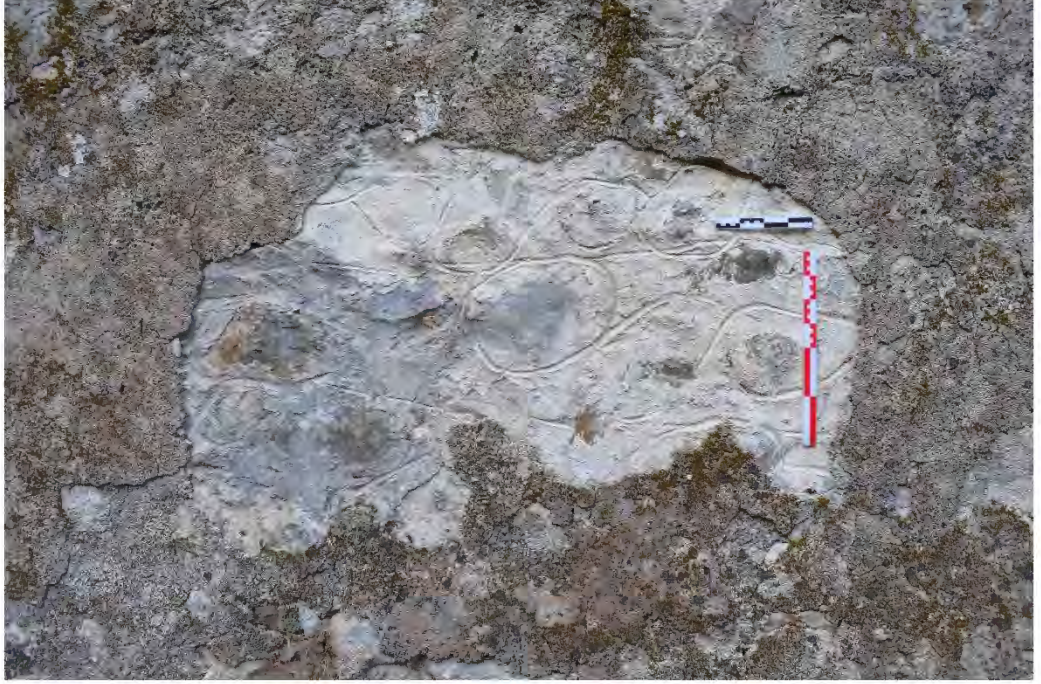
a) Piskoposluk Kilisesi dalgali çizgili derz harcı.
