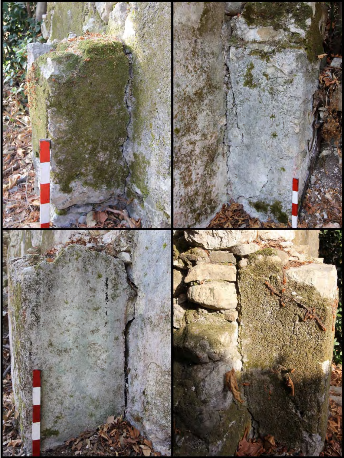
a) Vaftizhane güney nef duvarı ile batı duvarındaki payandalar arasındaki dilatasyon derzi.
