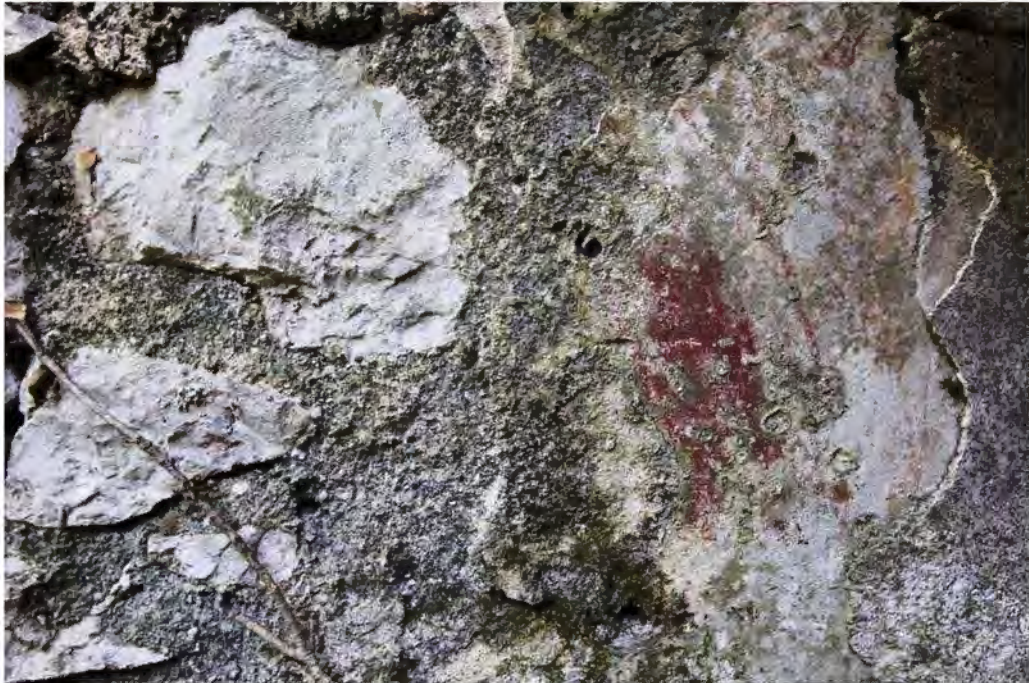
b) Yamaç Yerleşimi Aşağı Kilise atrium doğu cephe sıva tabakası.
